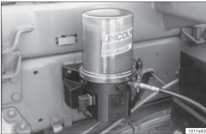
Abb. 21 - Behälter der Pumpe befüllen
